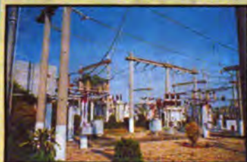
Trạm 110kV Vinh Yên là trạm đầu mối nhận lưới điện Quốc gia cho Vĩnh Phúc.
