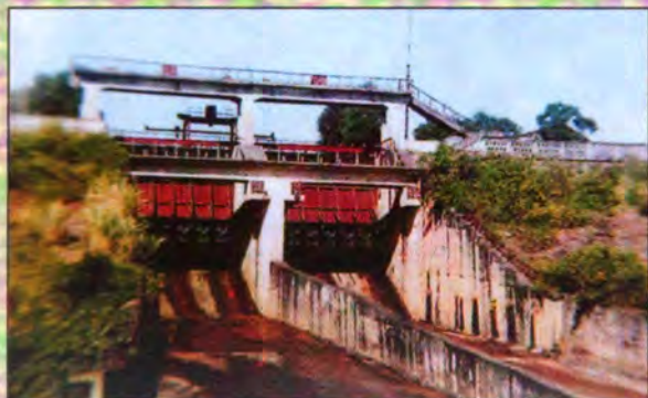
Cửa van cùng công trình tràn xả lũ kè gỗ Hà Tĩnh do Trường thiết kế
